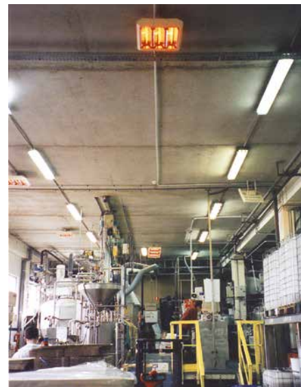
De IRCF wordt vaak geïnstalleerd in grote magazijnen. Zij zorgen voor directe en effectieve verwarming, waardoor ze zichzelf snel terugverdienen.
