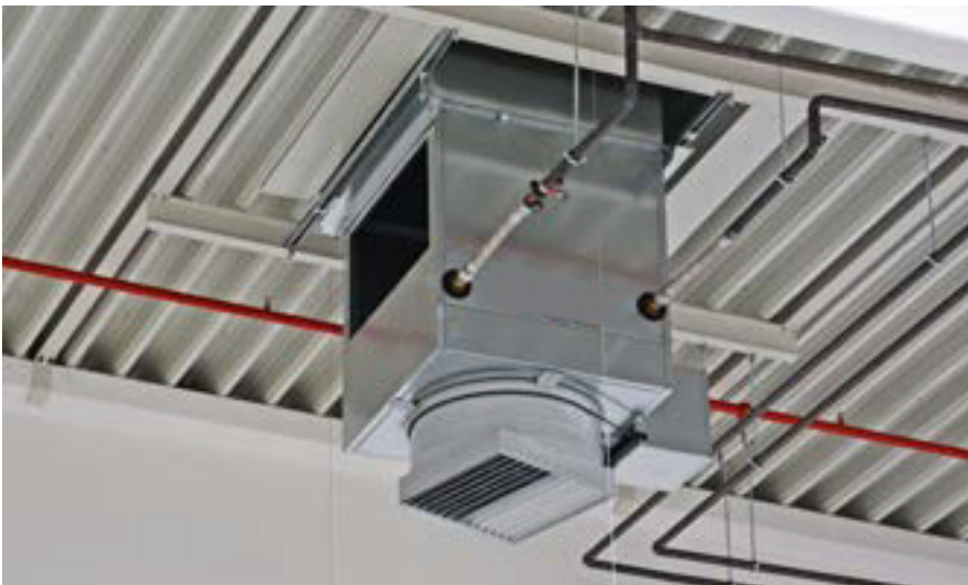
Industriehalle mit Deckenluftherzern RotaVent®
